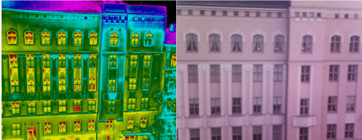
Kuvat 13. 1913 rakennetun asuinkerrostalon julkisivun lämpökuva ja valokuva. Kohteessa ei havaittu vaurioita tai eristevikoja.
