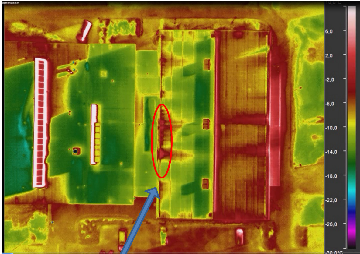
Kuva 39. Lämpökuvassa havaitaan selkeät ilmavuodot liikuntasalin reuna-alueilla. Kohde on ylipaineistettu +50Pa ylipaineeseen puolen tunnin ajaksi.
