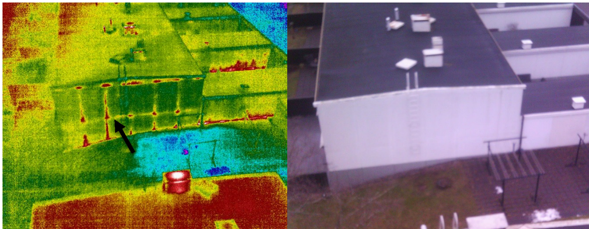
Kuvat 22. Betonisandwich-elementin saumoissa havaitaan melko suuret lämpötilaerot.
