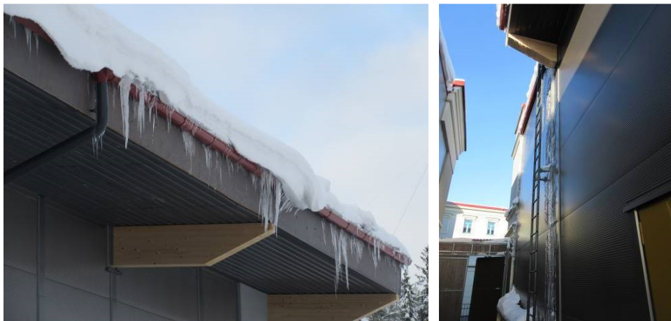
Kuvat 31. Jääpuikkojen muodostuminen rakennuksen räystäälle ja julkisivuun oli erityinen havaittava ongelma.
